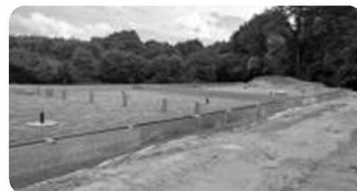
Station épuration mai 2014
